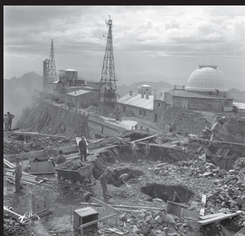
Studios Alix, Travaux au Pic du Midi, 29 août 1959. Inv. FAE-B142-Ph992 - © Fonds photographique Alix
